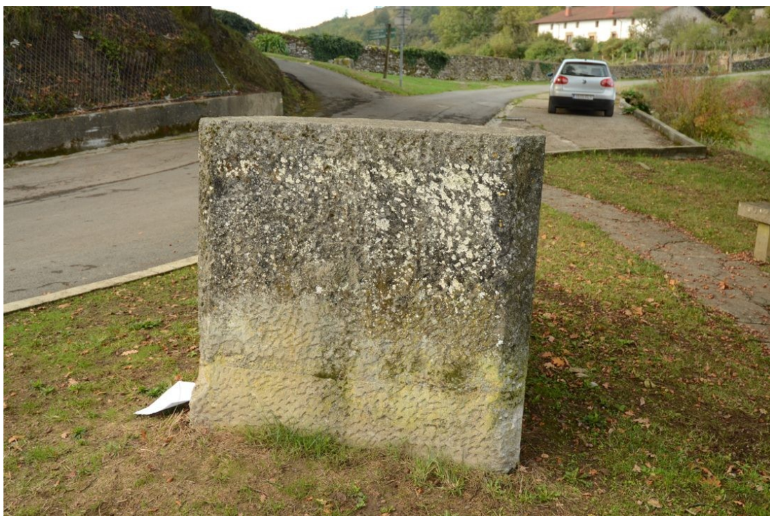
Figura 4. Cara posterior del bloque, hacia la carretera, con la colonización de líquenes en la mitad superior. Fotografía 0020, 09/10/2026.
