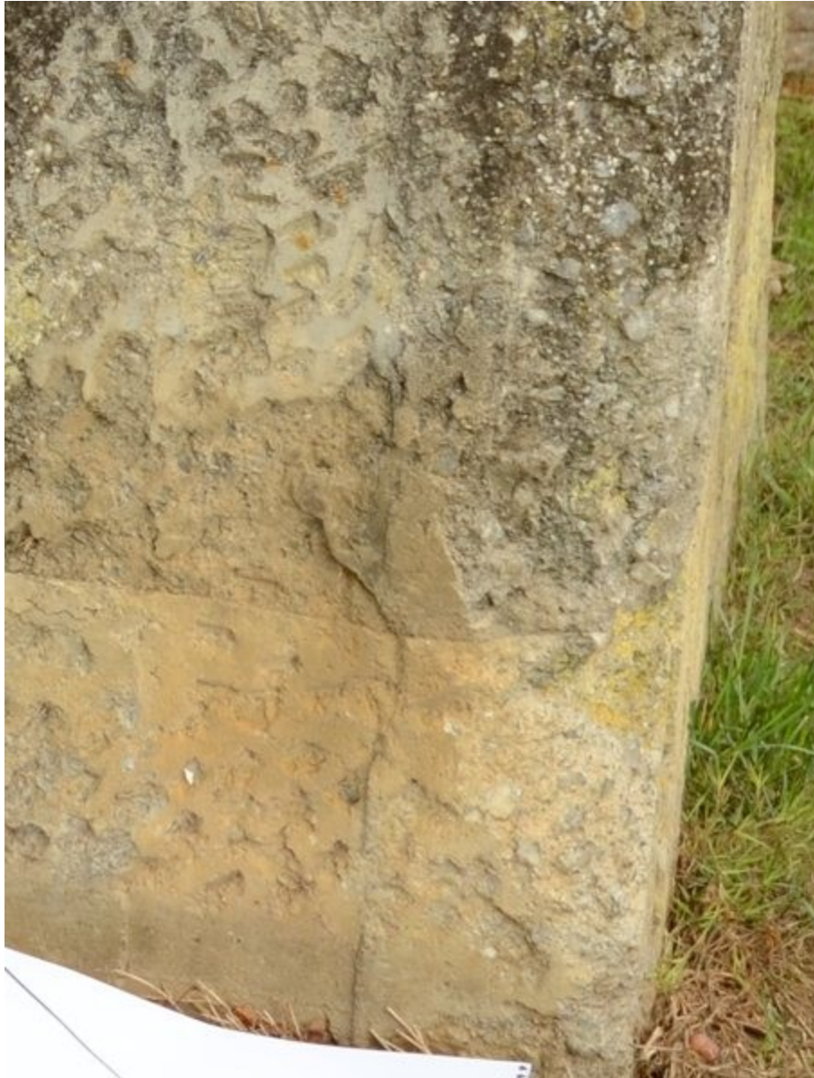
Figura 17. Línea horizontal y vertical en la base del bloque: ¿junta o grieta? Fotografía 0009.
